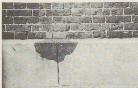
Fig. 3 L'apparence terne d'une partie des briques est due à un résidu résultant du nettoyage. Le résidu a formé une pellicule malgré un rinçage abondant. Lorsqu'on a à effectuer des essais sur des surfaces réduites, il faut toujours laisser le temps leur redonner leur apparence naturelle avant de poursuivre les travaux.
