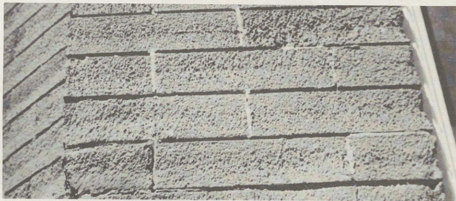
Fig. 5 Cet appareil de briques a été sablé sous pression pour en enlever la peinture. Notez les graves effets de l'érosion qui a résulté de l'opération, affectant notamment l'intérieur plus tendre de ces briques du 19 e siècle, cuites à haute température. Il s'agit là d'un cas limite, mais un travail de sablage effectué avec davantage de soin n'en aboutirait pas moins, quoique de façon moins apparente, à augmenter la rugosité et la porosité.
