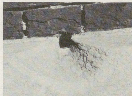
Fig. 1 A l'origine, l'ancre de fer que l'on voit ici n'était pas visible. La rouille en ayant augmenté le volume, elle a exercé des pressions internes qui ont fait éclater la pierre. C'est en étudiant minutieusement une construction que l'on peut déceler ce genre d'anomalie et en tenir compte lors de la préparation d'un programme de nettoyage.
